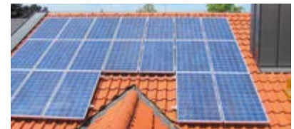
StWD Elektroinstallation - PV-Anlage in Dorfen © StWD
