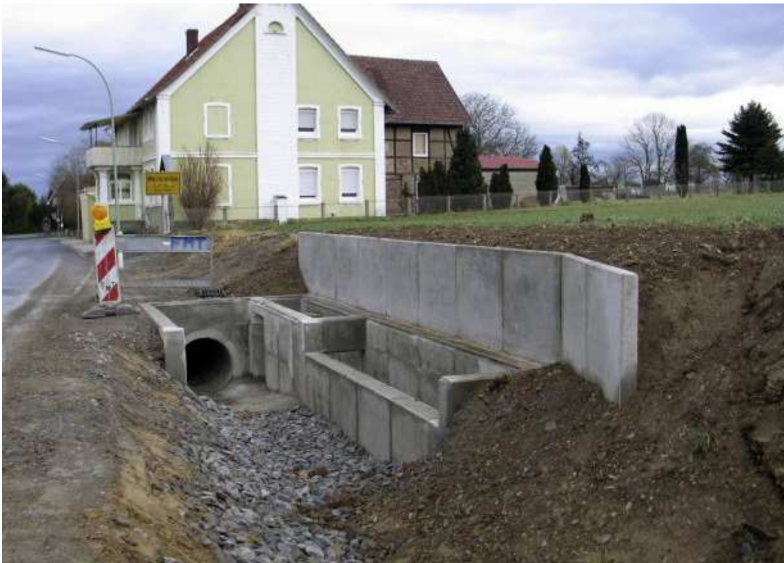
Abb. 3: Überlauf-Umleitung eines Gewässers vor einer Engstelle (Drosselbauwerk)
