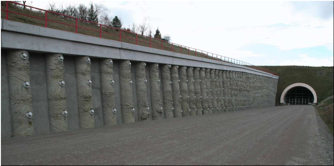
Abb. 8: Aufgelöste Bohrpfahlwand mit Spritzbetonausfachung, Rückverankerung und Kopfbalken an der ICE-Strecke Nürnberg - Erfurt Quelle: Wikipedia, Tunnel Augustaburg
